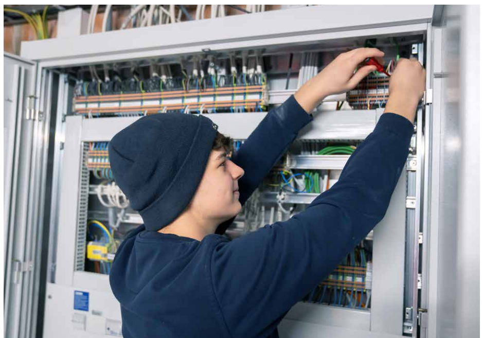
Florian bei der Arbeit an der Energieverteilung des modernen Gebäudes mit umfangreicher Gebäudetechnik und einer Photovoltaik-Anlage.
